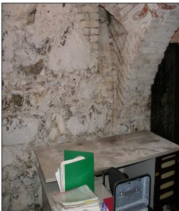
Ungeeignetes Aktenlager in einem feuchten Keller
