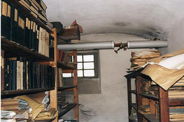
Wasserleitung durch das Aktenlager
